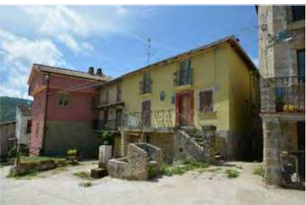
Largo pubblico con edifici danneggiati
