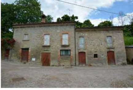
Edifici storici su area pubblica in parte puntellata
