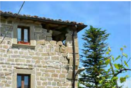
Palazzo privato danneggiato cantonale lesionato su area pubblica
