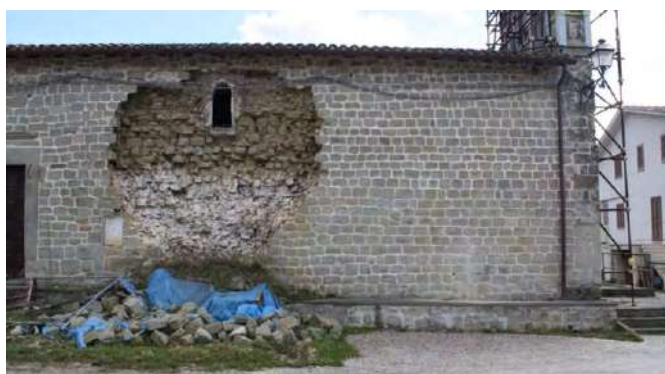
Chiesa di San Nicola – Stato di danno verificatosi durante i rilievi.
