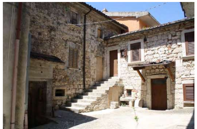
Cesano fabbricati riparati e in fase di riparazione
